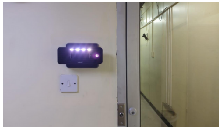
Sistema de control de acceso: ilock Iris.
