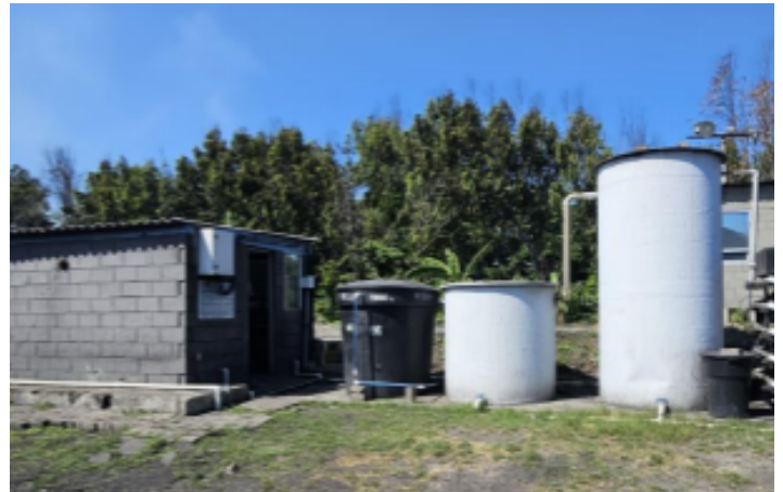
Vista lateral planta de tratamiento, floculación, filtración.
