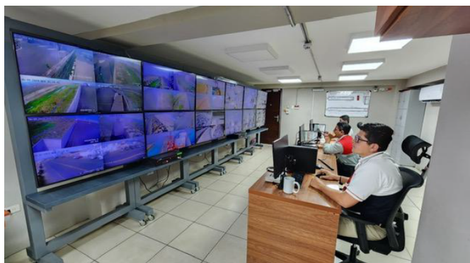
Amplia área de CCTV.
